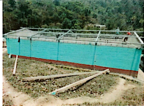
Foto 2: Se puede observar la instalación de las vigas y costaneras de metal.
